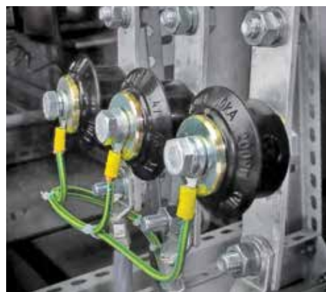
ОПН-КР/TEL-0,4/0,46 установленный на опоре ВЛ и в составе закрытого РУ 0,4 кВ
