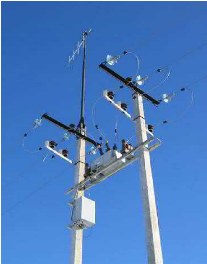
Рис.1.1. Общий вид реклоузера
