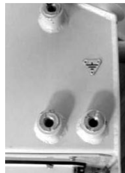
Отверстие под болт заземления
