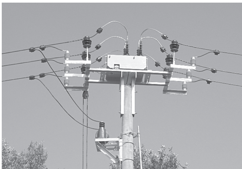
РВА\TEL-10 в составе СЦБ железнодорожного транспорта
