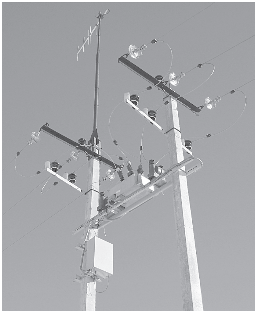
Пункт секционирования ВЛ с двусторонним питанием на базе РВА\TEL-10
